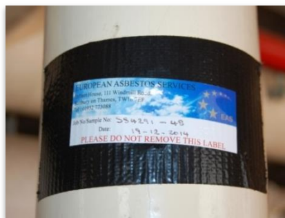
Tubería recubierta de amianto. Fuente: UEPG
